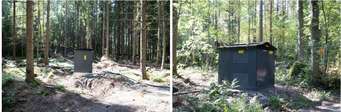
Parinkalliontien varressa on kaksi puistomuuntamoaa.
